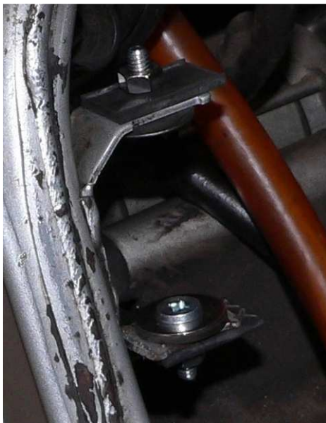
Utilisation du support de pompe avec caoutchouc de faible épaisseur de chaque côté, pour la fonction silentbloc. On notera les boulons avec tête plate et la rondelle sous la tête des boulons.
